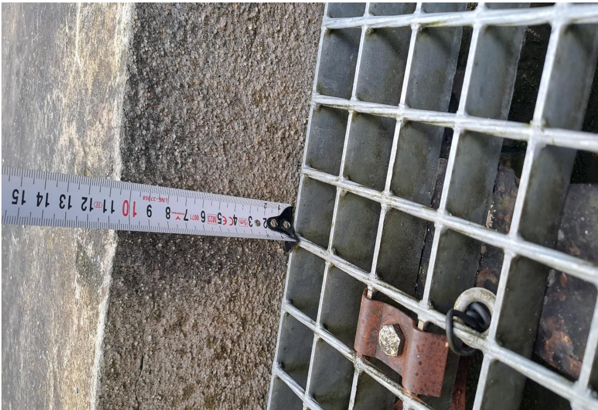
Rysunek 2. Wysokość krat poniżej poziomu betonów.
