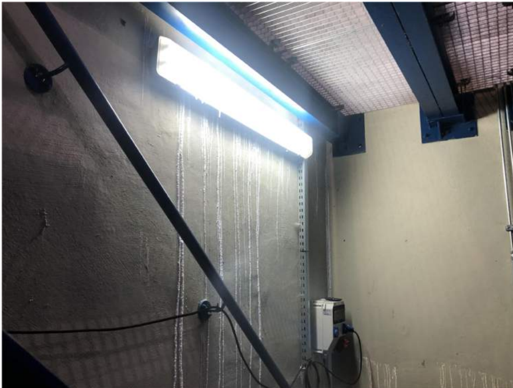
Zdjęcie nr 26 Elektrownia Trzebiatów – przesiąkanie wody.
