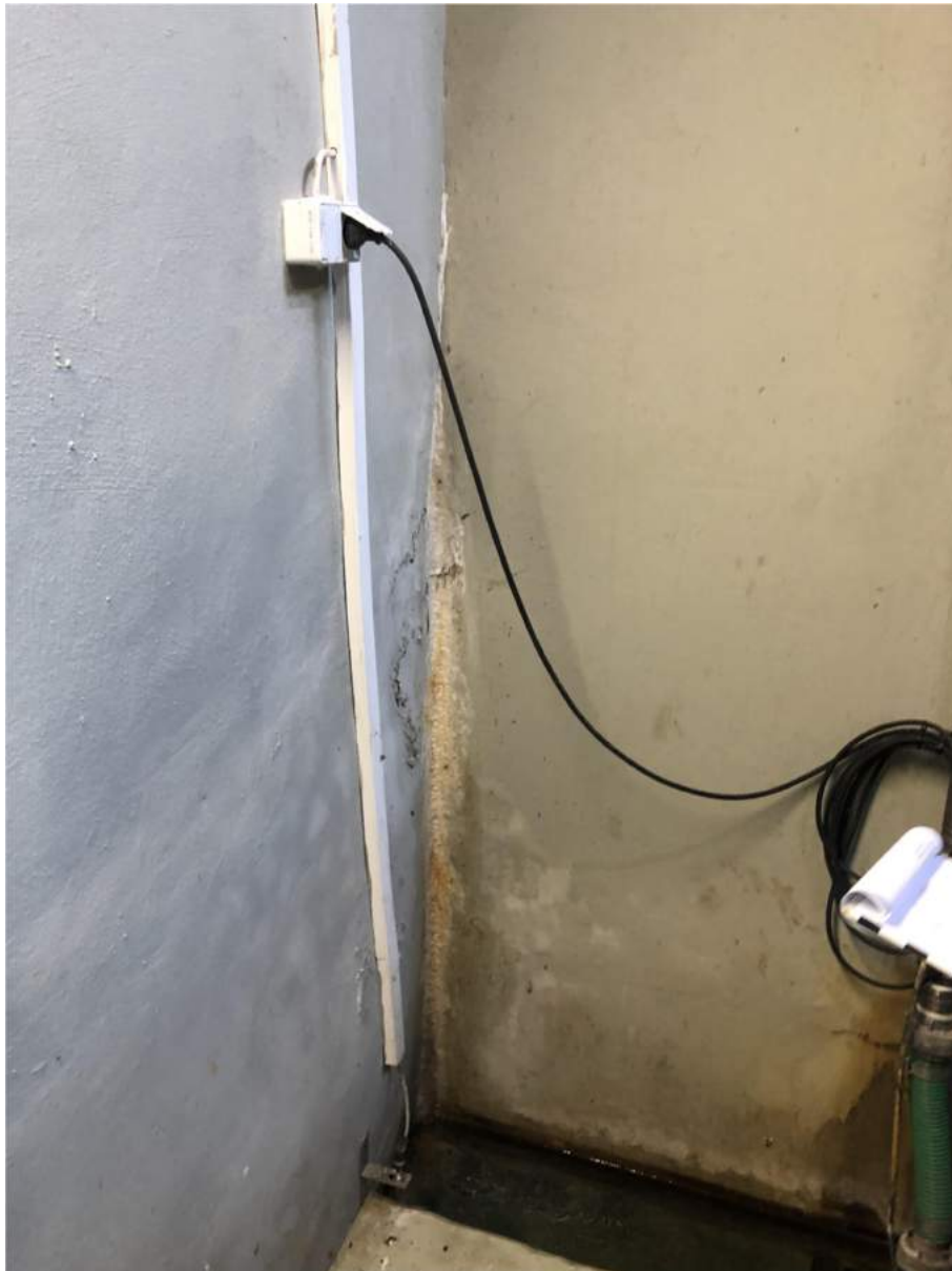
Zdjęcie nr 27 Elektrownia Trzebiatów – przesiąkanie wody.
