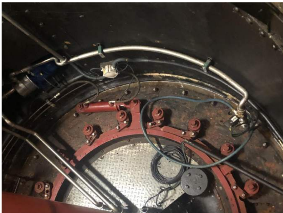
Zdjęcie nr 12 Elektrownia Bledzew – przecieki wody z rury ślimakowej.
