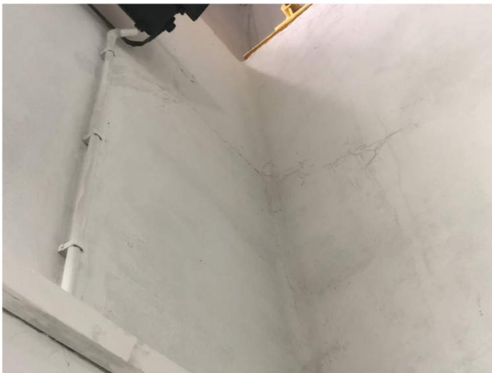
Zdjęcie nr 24 Elektrownia Kamienna – przesiąkanie wody.
