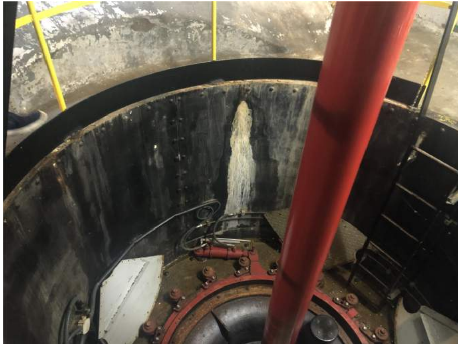
Zdjęcie nr 11 Elektrownia Bledzew – przecieki wody z rury ślimakowej.
