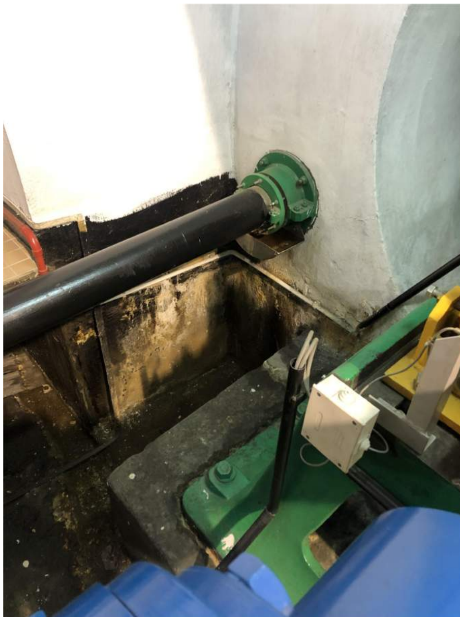
Zdjęcie nr 22 Elektrownia Kamienna – przesiąkanie wody w niecce generatora.
