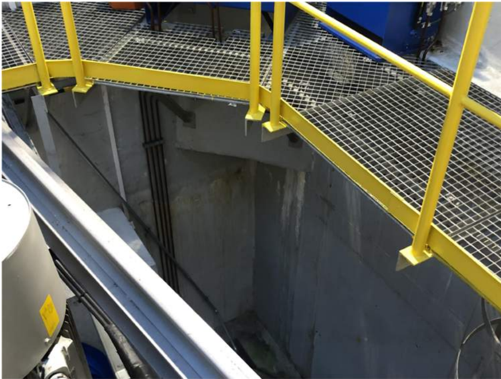
Zdjęcie nr 5 Elektrownia Likowo – HZ 3.
