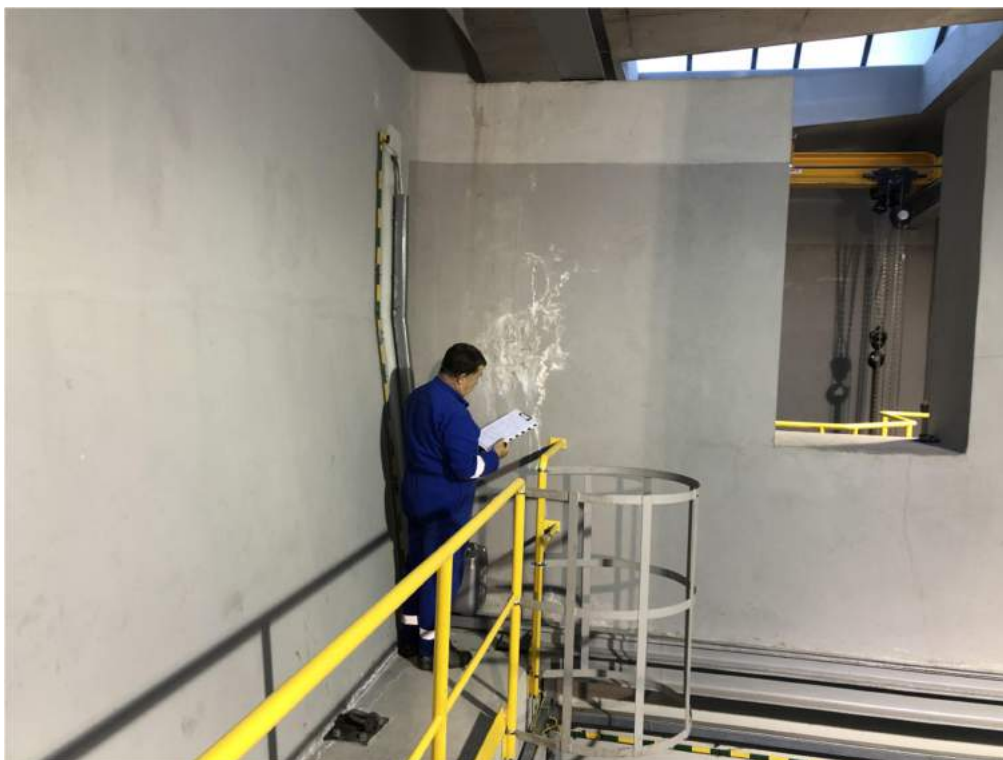
Zdjęcie nr 3 Elektrownia Likowo – HZ 2.
