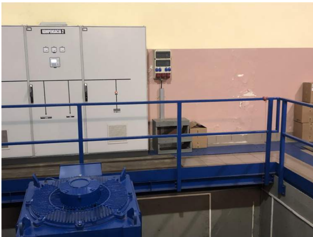
Zdjęcie nr 6 Elektrownia Rejowice – konieczne jest przestawienie szafy kompensatora.
