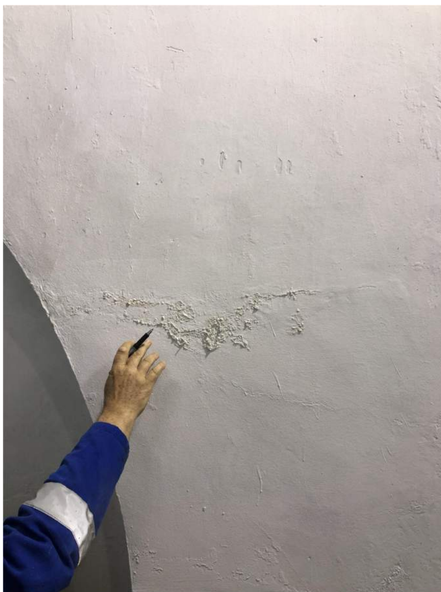
Zdjęcie nr 18 Elektrownia Kamienna – przesiąkanie wody.
