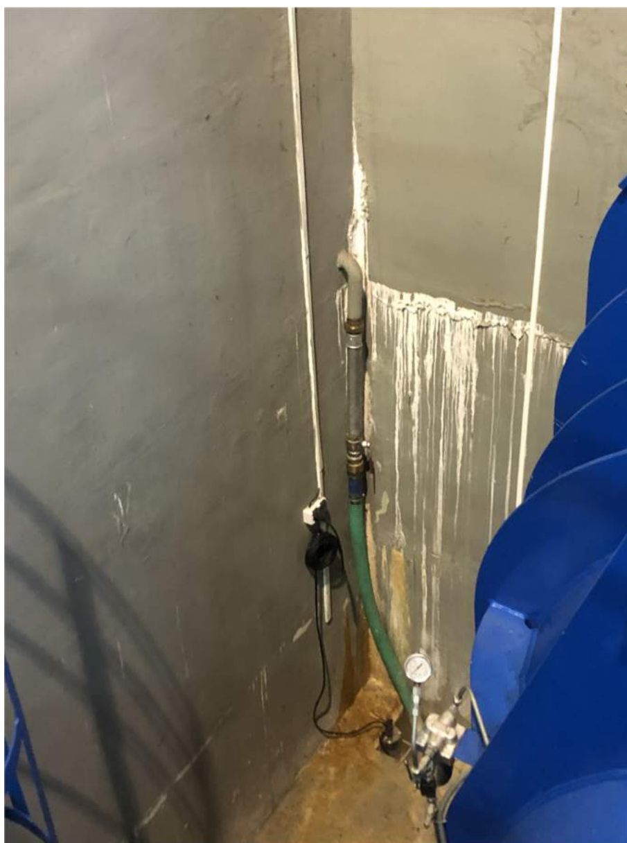
Zdjęcie nr 9 Elektrownia Rejowice – przesiąkanie wody HZ-1.
