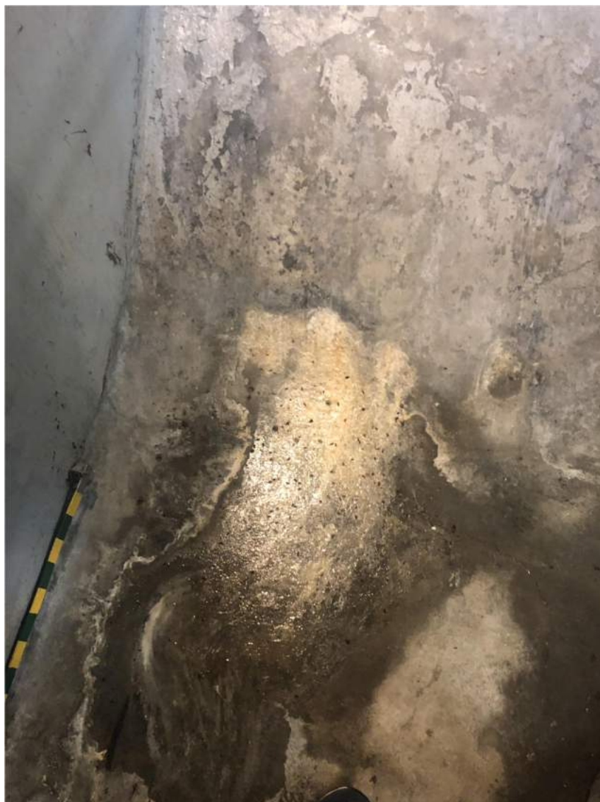
Zdjęcie nr 15 Elektrownia Bledzew – przesiąkanie wody.
