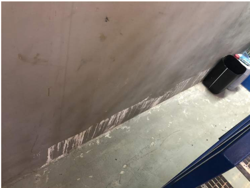
Zdjęcie nr 8 Elektrownia Rejowice – HZ 1 – przesiąkanie wody.
