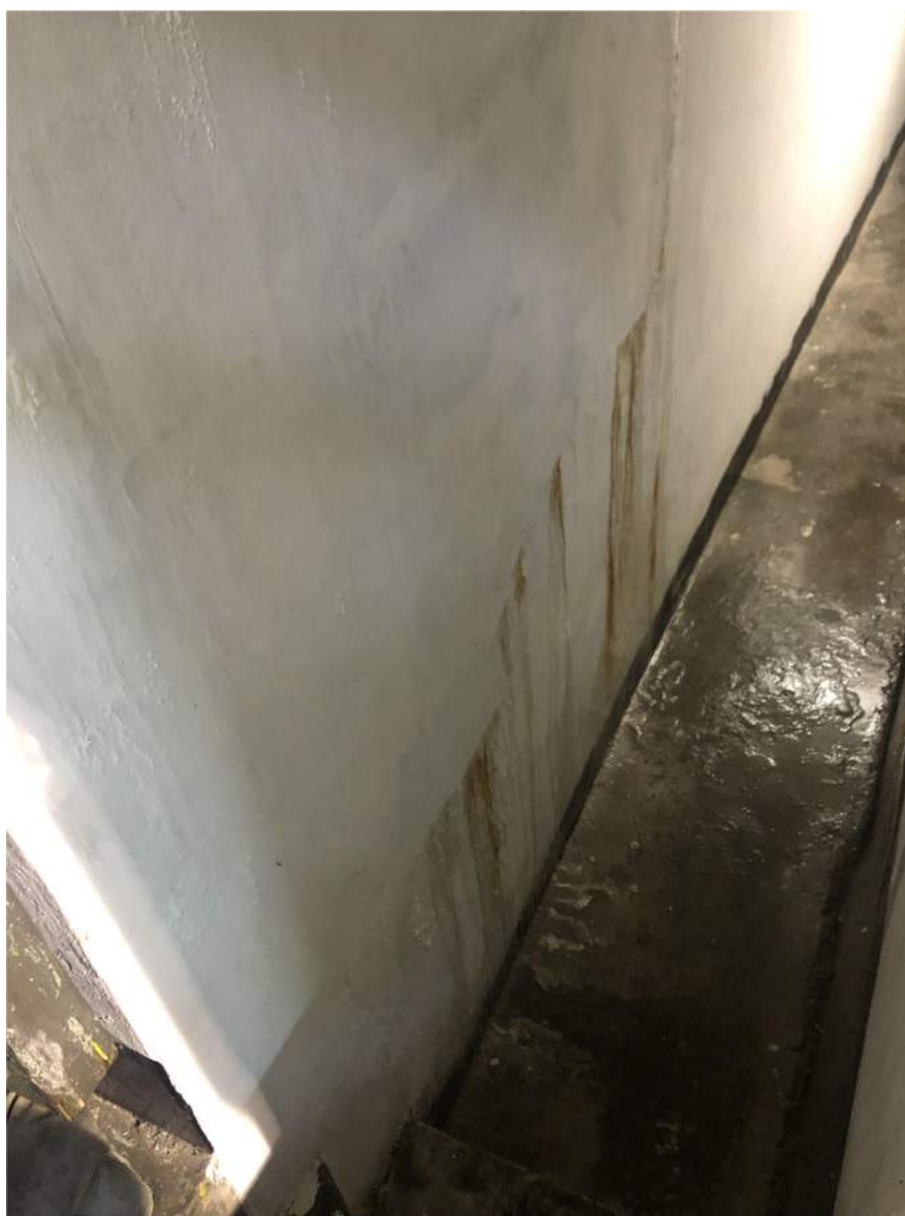
Zdjęcie nr 21 Elektrownia Kamienna – przesiąkanie wody w Sztolni.
