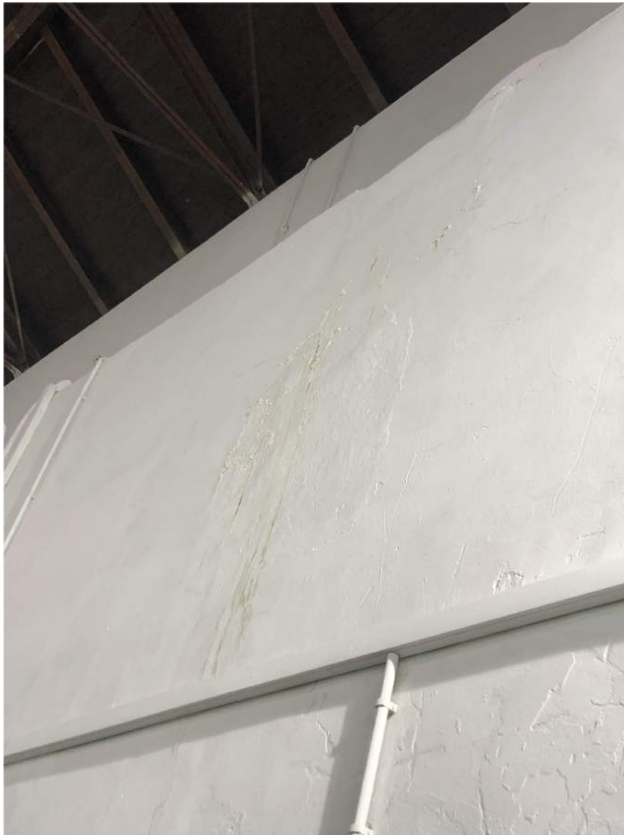
Zdjęcie nr 23 Elektrownia Kamienna – przesiąkanie wody.
