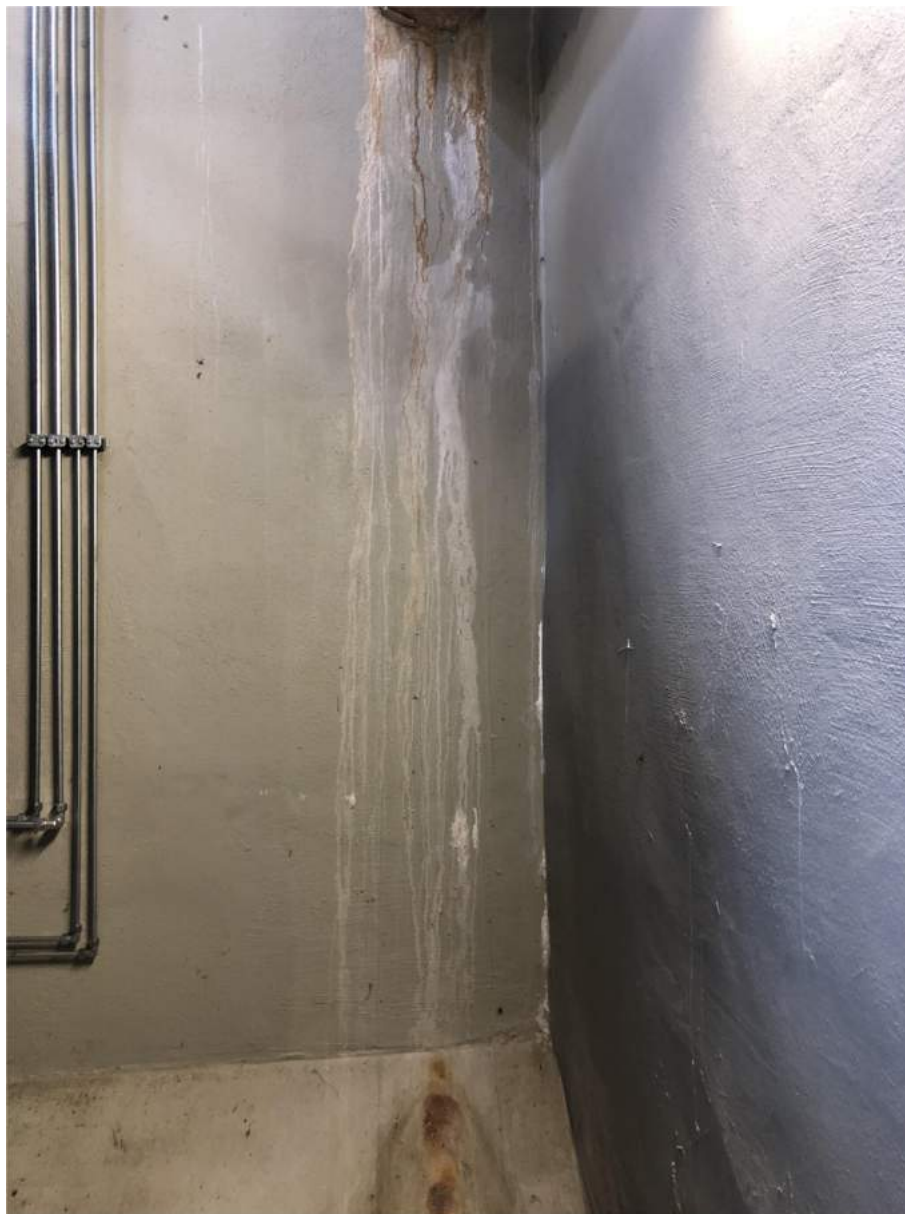
Zdjęcie nr 25 Elektrownia Trzebiatów – przesiąkanie wody.
