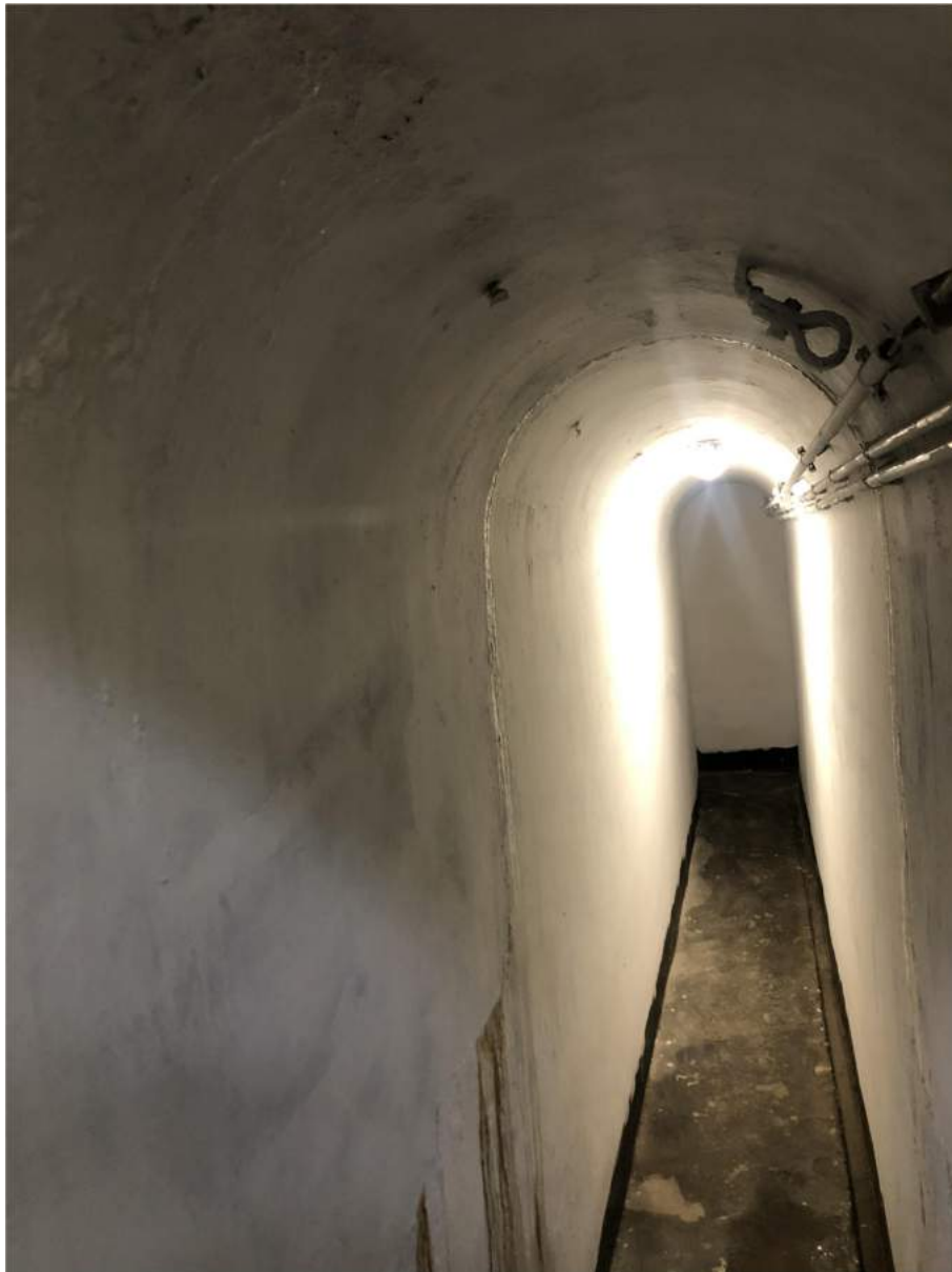
Zdjęcie nr 20 Elektrownia Kamienna – przesiąkanie wody w Sztolni.
