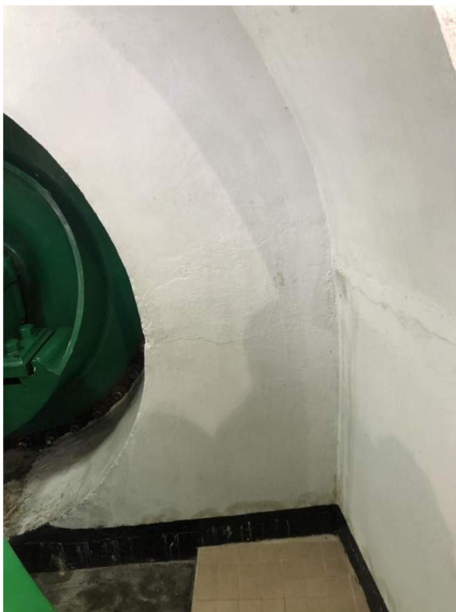
Zdjęcie nr 19 Elektrownia Kamienna - przesiąkanie wody.
