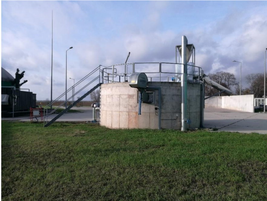
Rys. 5. Zbiornik naziemny wstępny na płynne substraty (zbiornik pełni jednocześnie inne funkcje: czasowe magazynowanie płynnej frakcji po separacji produktów pofermentacyjnych i wód deszczowych oraz roztopowych).
