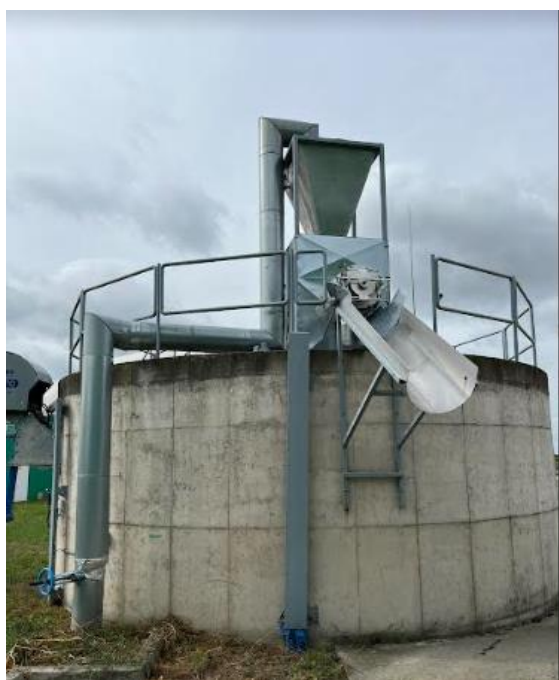
Rys. 7. Separator masy pofermentacyjnej zamontowany na zbiorniku wstępnym.
